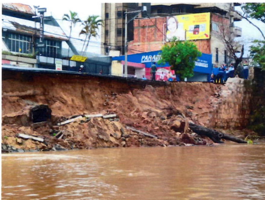
Figura 5 – Escorregamento do solo-base da via
